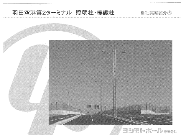
08 羽田空港第2ターミナル 照明柱・標識柱
