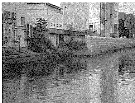
図9 堀川護岸整備の切れ目
